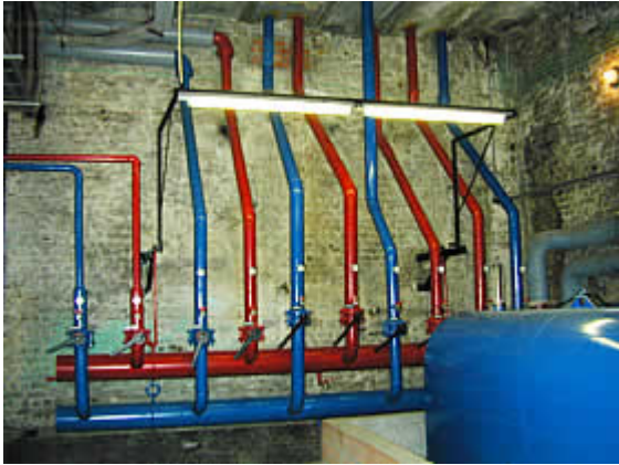
Sous-station de distribution sans isolation !
