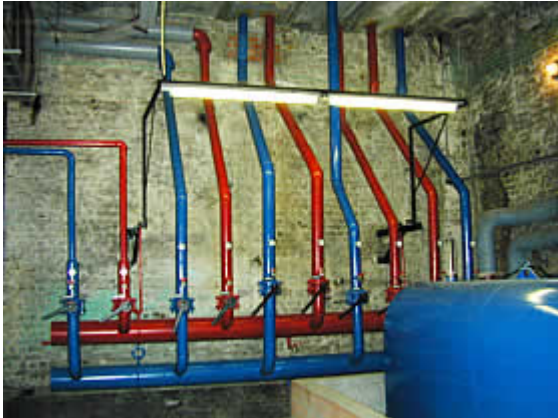
Sous-station de distribution sans isolation !
