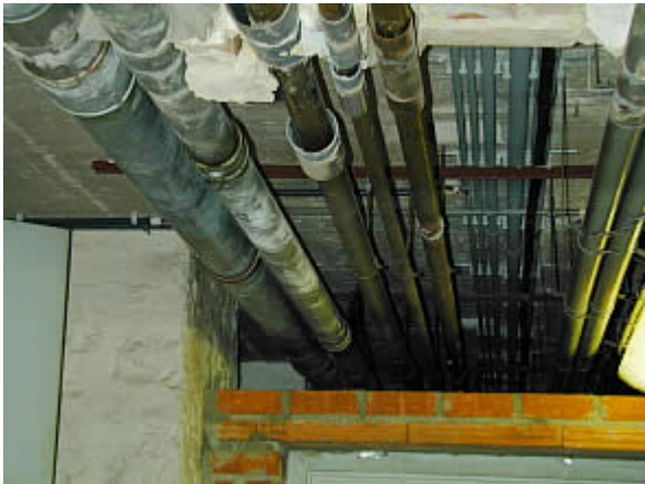
Boucle de distribution d'eau chaude sanitaire non isolée, dans un vide ventilé de 100 m de long !
