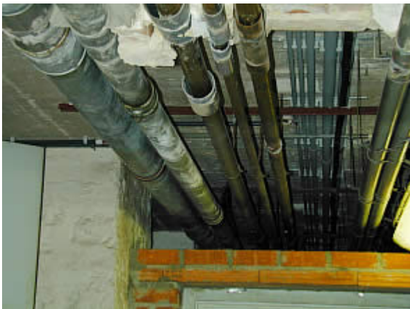
Boucle de distribution d'eau chaude sanitaire non isolée, dans un vide ventilé de 100 m de long !
