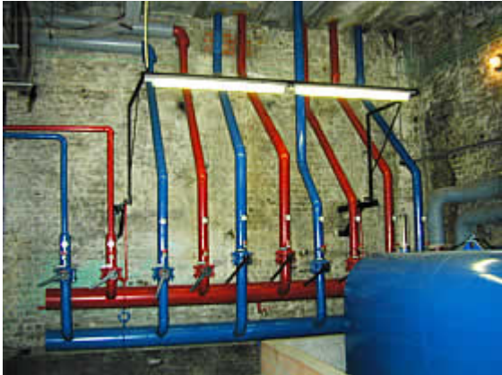
Sous-station de distribution sans isolation !
